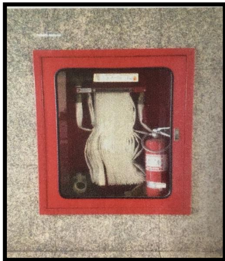
ตู้เก็บพร้อมสายฉีดดับเพลิง (Fire Hose Cabinet) ประกอบด้วยถังดับเพลิงชนิดผงเคมีแห้งขนาด ๑๓.๔ ปอนด์ จำนวน ๑ ถังต่อ ๑ ตู้ พร้อมสายฉีดน้ำดับเพลิงซึ่งมีลักษณะเป็นสายอ่อนม้วนเป็นขด (Hose Reel) พร้อมหัวฉีด
